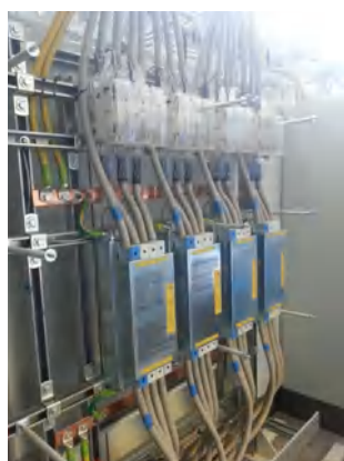
Esempio di protezione di un Data Center con 4 scaricatori ILF 4P 400 in parallelo
