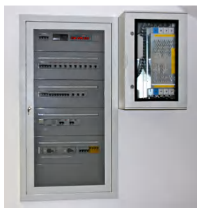
Esempio di protezione di un Data Center con uno scaricatore ILF 4P 250 effettuata in occasione di un ammodernamento
